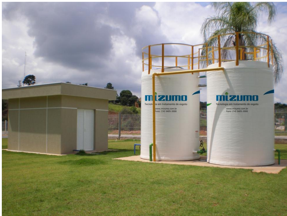
Figura 1 - ETE Mizumo modelo Tower instalada
