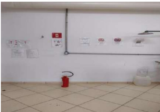
Figura 25 - Prédio A – 2º Andar (LaB. Química)
